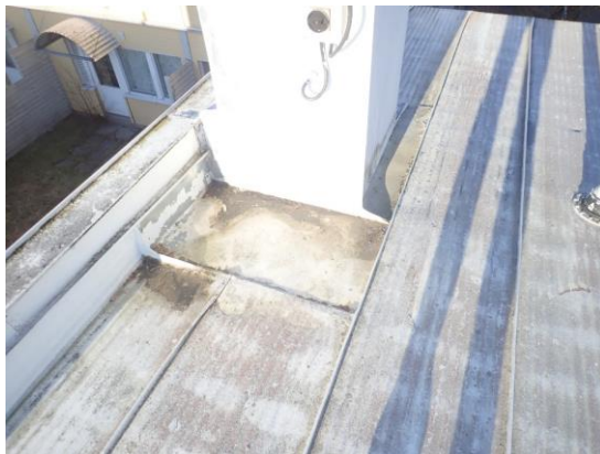
Kuva 31. Vesikatteen pinnassa havaittiin vähäistä maalin irtoamista.
