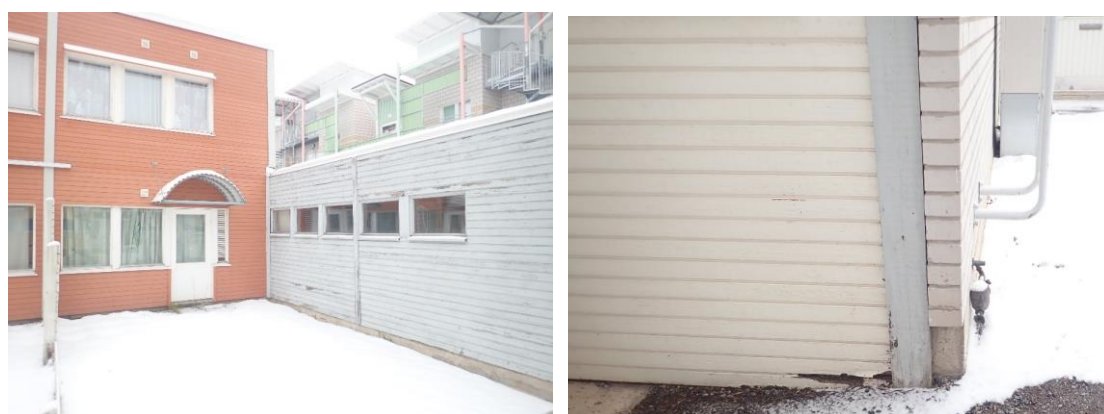
Kuvat 20 A ja B. Puupaneeliverhottujen julkisivujen kunto on aistinvaraisesti tarkasteltuna pääosin tyydyttävä ja paikoin heikko tai jopa erittäin heikko.
