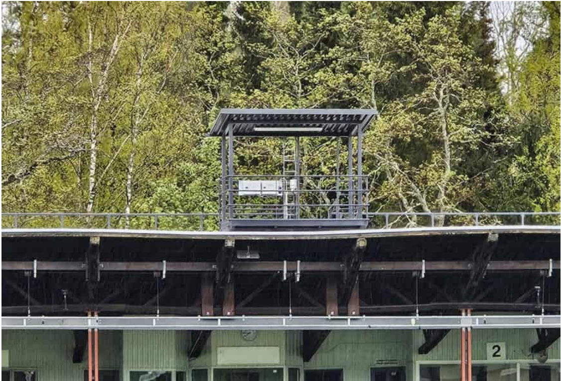
Kuva 40. Katolle on tehty kuvausaitiot vuonna 2015. Katto on notkahtanut rakenteen painosta, vaikka kattorakennetta on vahvistettu uusilla metallikiskoilla.
