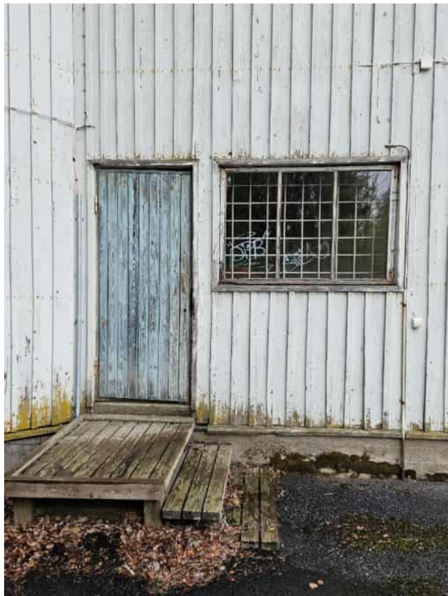
Kuva 37. Puukatsomon ylläpito on lopetettu ja rakennus on asetettu käyttökieltoon.
