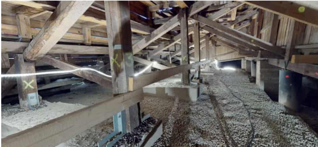
Kuva 13. Istuinosaan alapuolella olevat vahvistetut perustukset olivat pääosin hyvässä kunnossa.
