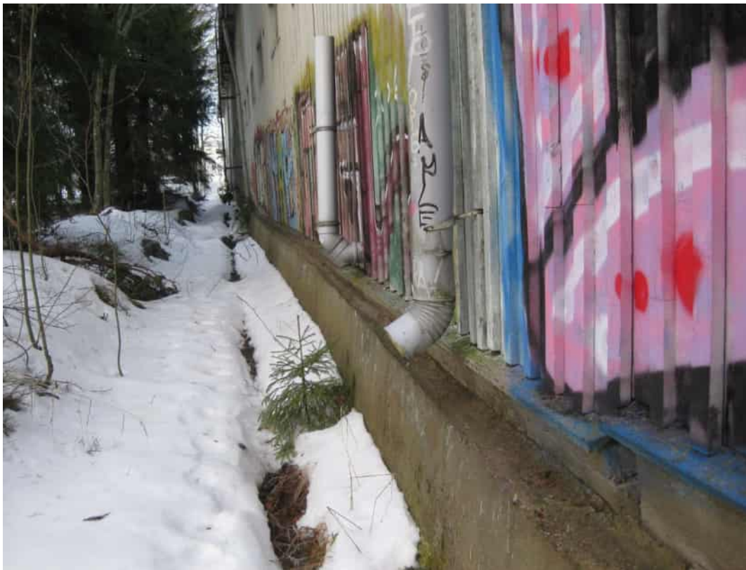
Kuva 23. Katoksen takajulkisivu. Julkivulaoituksen alareuna sekä sen alapuolella oleva puinen lista ovat huonossa kunnossa. Maanpinta kallistaa rakennusta kohti ja sen seurauksena pintavedet valuvat rakennukseen päin.
