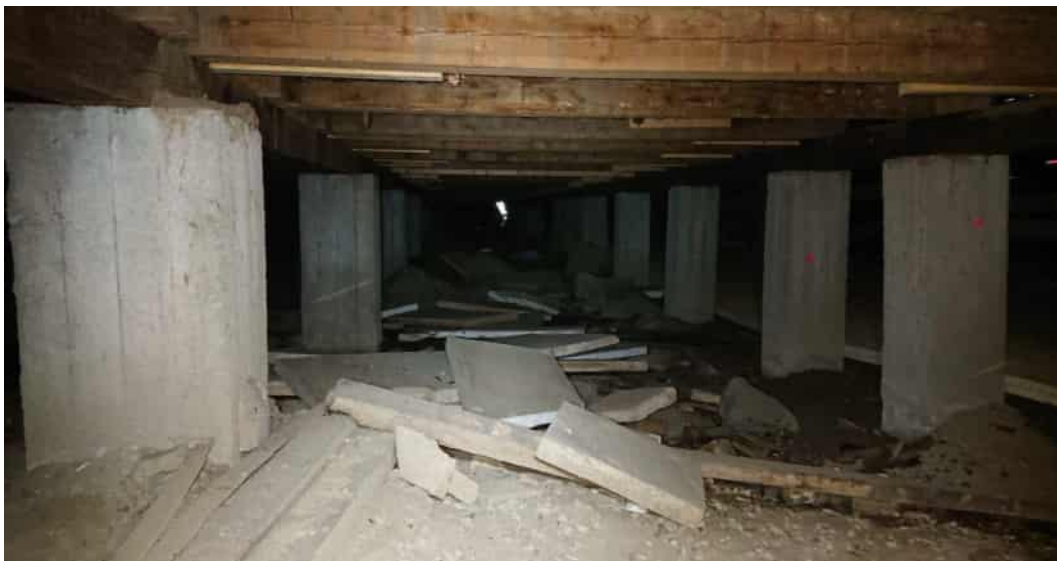
Kuva 17. Perustukset. Kentän puoli vasemmalla. Katsomorakennuksen eteläpäässä osa alkuperäisistä perustuksista on pysynyt suorassa.
