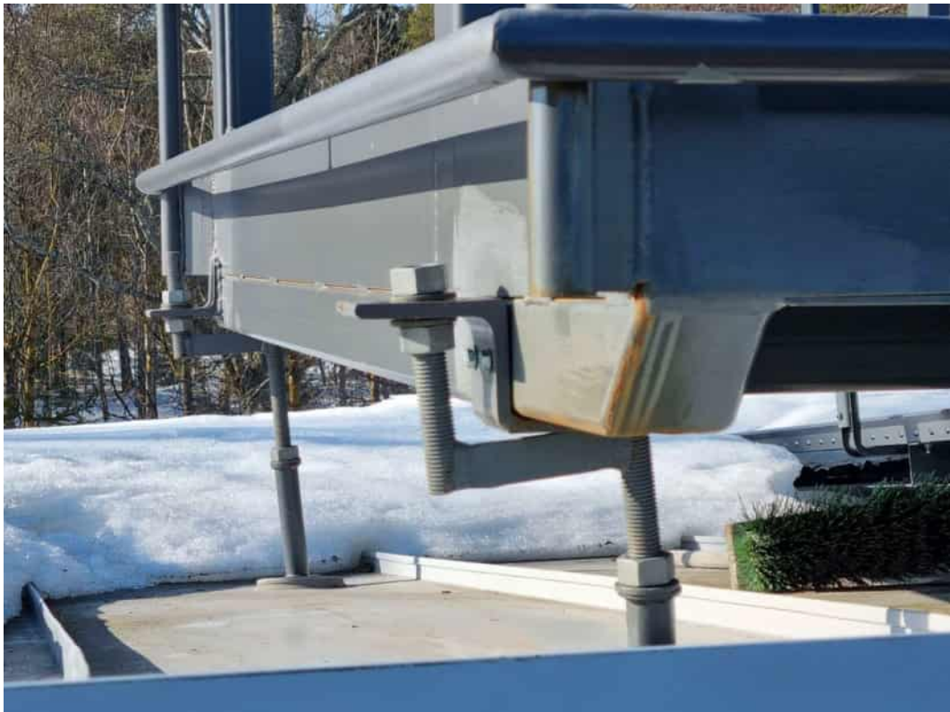
Kuva 12. Vesikaton on vuonna 2016 lisätty katokset televisiokameroita varten. Kiinnityspisteet ovat taipuneet. (Kuva Ramboll Finland Oy)
