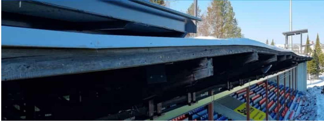
Kuva 11. Vesikaton räystäään etureuna. Alkuperäisen primääriristikon varsin suurten taipumien takia räystääslinja on hyvin mutkitteleva. (Kuva Ramboll Finland Oy)
