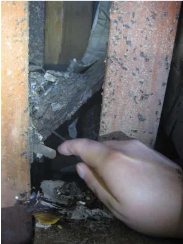
Kuva 19. Katoksen kentän puoleisen teräspilarin alapää. Teräspilarin sisällä oleva jäykistelevy on alapäästä pahoin ruostunut ja ainevahvuus on ruostuneen osan kohdalla vähentynyt n. 8mm → 4mm.
