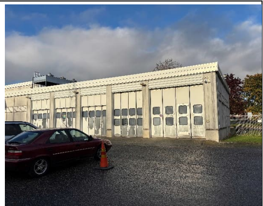
Kuva 9. Alkuperäisen osan autohallin ovet ovat huonossa kunnossa.
