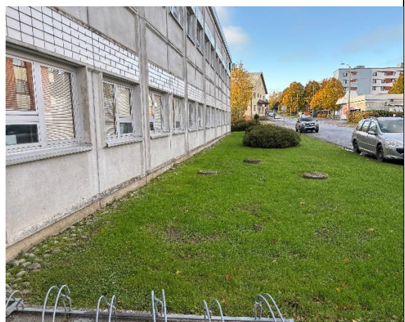
Kuva 3. Ahventien puolella maanpinta ei ollut kallistettu poispäin rakennuksesta.
