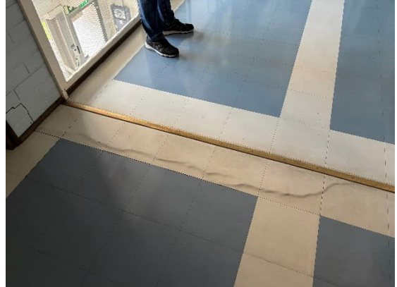
Kuva 14. A-portaan vieressä halkeama 2. kerroksen lattiassa.
