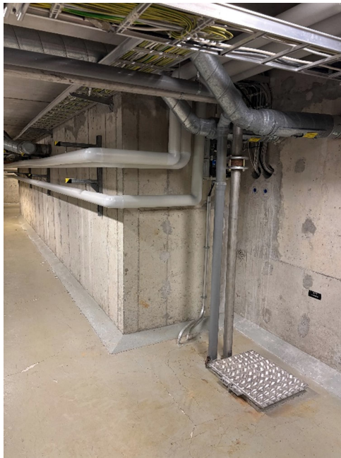
Kuva 11. Kellarin lattiapinnat halkeilleet ja seinien vierelle tehty valunostoja/tiivistyksiä.
