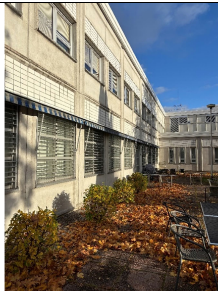
Kuva 7. Sisäpihan maanpinta lähellä sisäpuolen lattiapintaa ja maanpinta ei kallistanut poispäin rakennuksesta.
