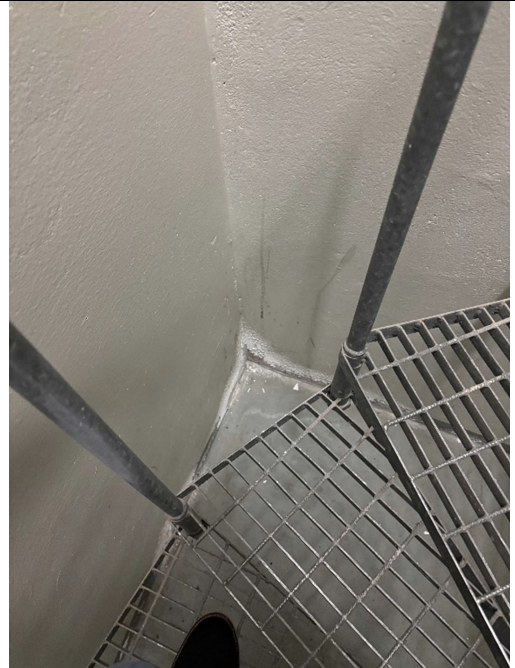
Kuva 12. Porrashuoneen C alaosaan havaittavissa kosteuden aiheuttamaa vauriota.
