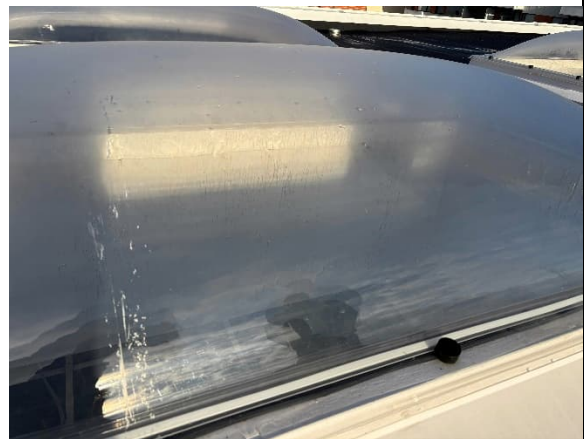
Kuva 5. Vesikatolla lasikupuja, joissa havaittavissa kosteuden tiivistymistä.
