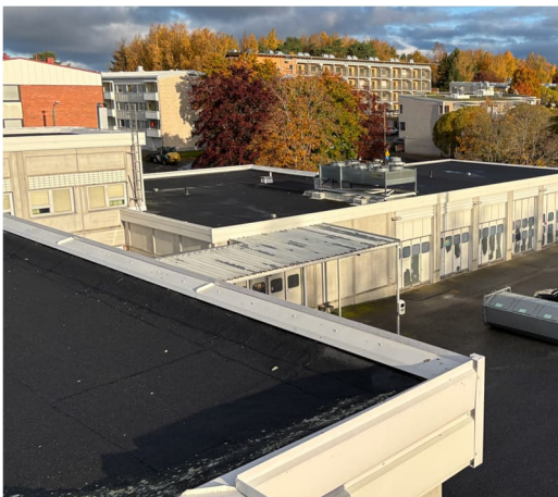
Kuva 6. Sisäpihan katoksen profiilipellin maalit lähteneet osittain irti.
