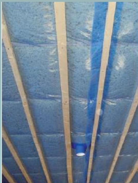
Höyrynsulku on limitetty kattoverhouksen koolauksen kohdalta.
