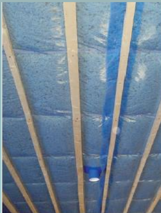
Höyrynsulku on limitetty kattoverhouksen koolauksen kohdalta.
