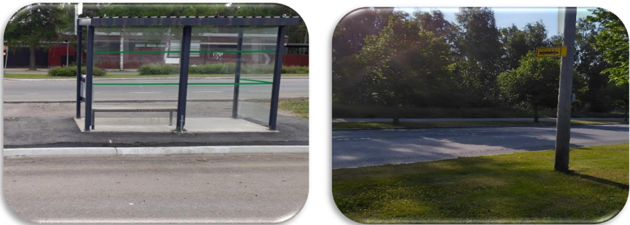
(Kuva 31. Korkeat reunakivet kevyenliikenteenväylän puolella estävät pääsyn pysäkillä Kappelinmäentiellä. Toisessa kuvassa pysäkkialue on nurmikkoo, jossa liikkuminen pyörätuolin kanssa on vaikeaa.)
