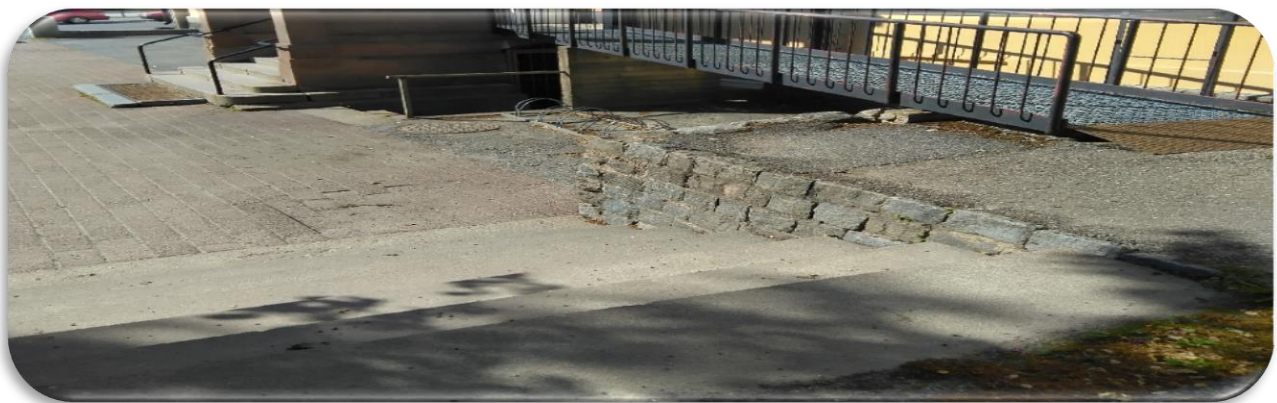
(Kuva 4. Luiskalle päästäkseen joutuu kiertämään rakennuksen toiselle puolelle.)
