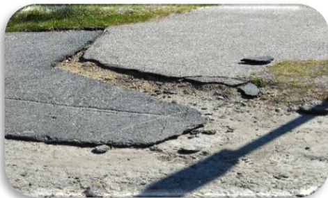
(Kuva 28. Rikkoutunut asfaltti suojatien alkamiskohdassa Naapurinkadun ja Erämiehenkadun risteyksessä.)
