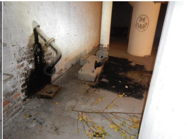
Kuva 4.19 Öljyä kellaritilan rakenteissa
