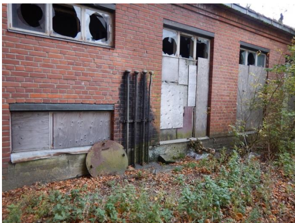
Kuva 4.20 Öljyputkia kattilahuoneen ulkoseinällä (ei kuulu varsinaiseen tutkimusalueeseen)
