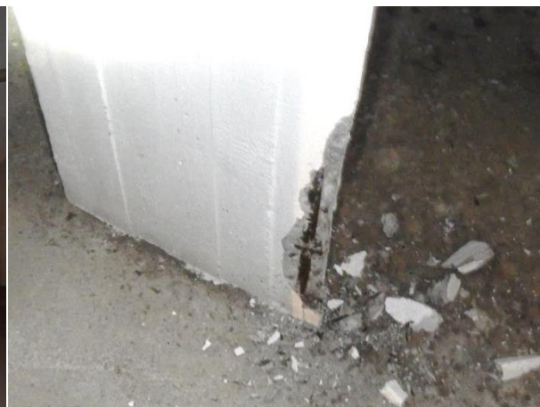
Kuva 4.15 Pilarin alapään raudoite näkyvissä
