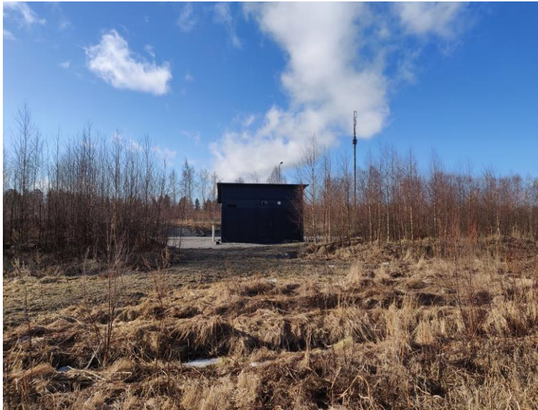
Kuva: Kaukolämmön pumppaamo Välitien varrella.
