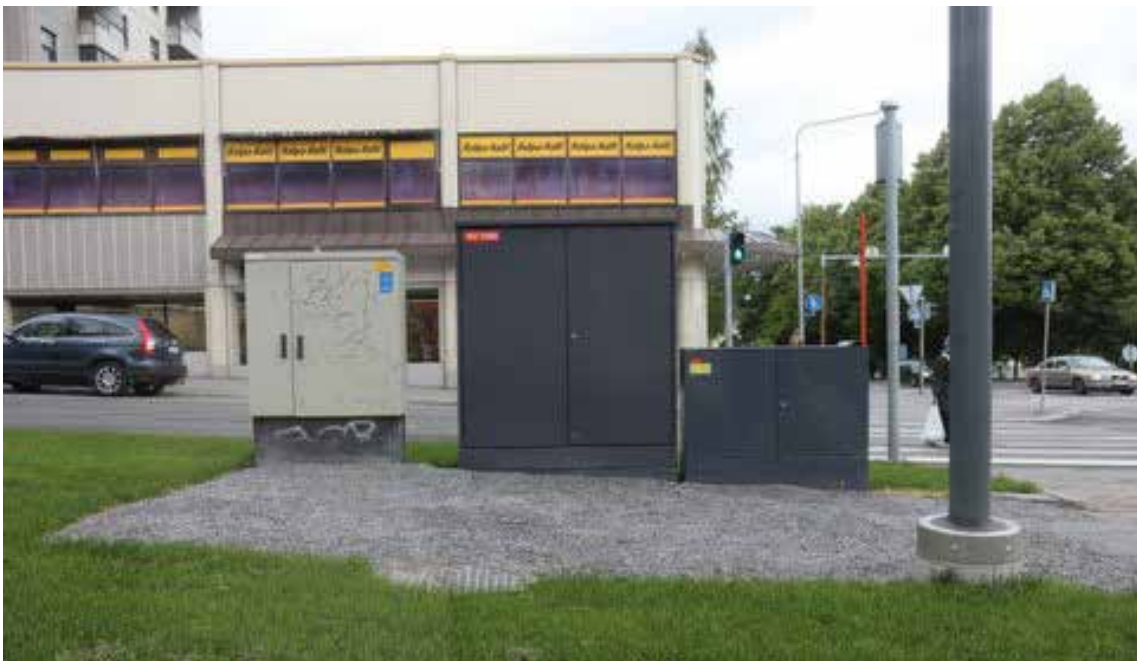
BILD: Transformatorer vid Vasaesplanaden (Outi Orhanen)
