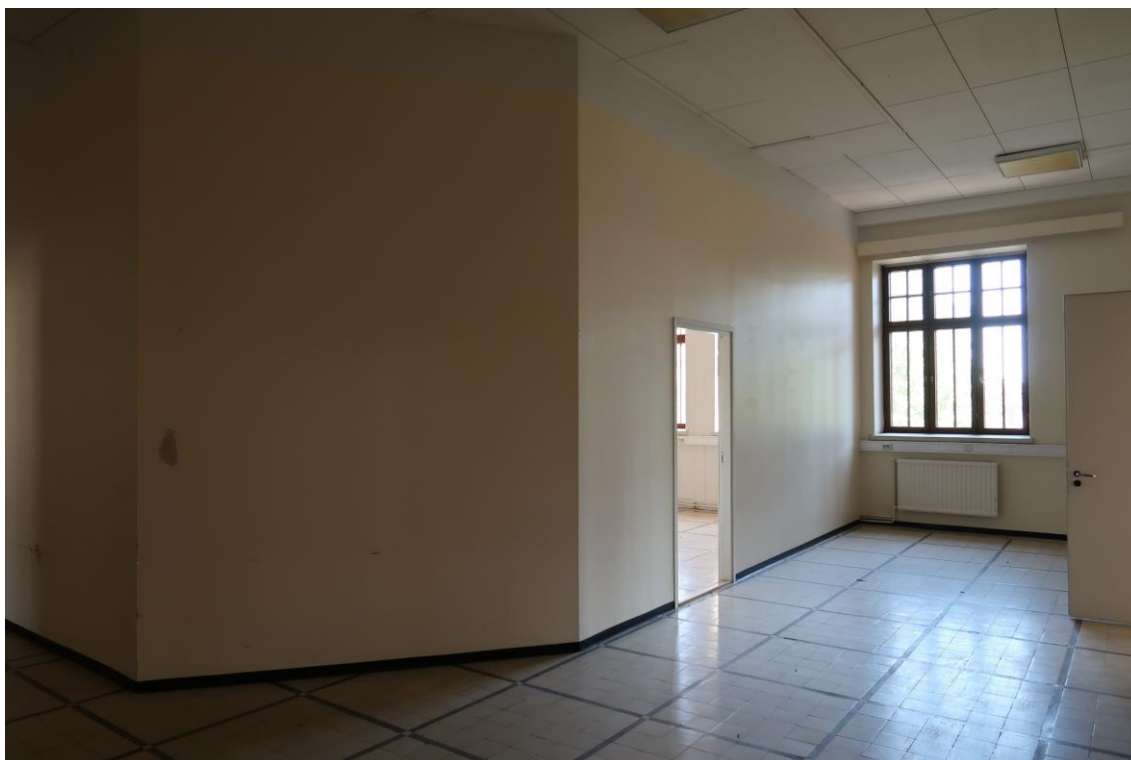
Kuva 73. Aulatilojen jakaminen luokiksi ja käytäväksi on rikkonut alkuperäisen tilallisen idean rakennuksessa. Kuva 2021.
