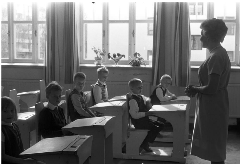
Kuva 56. Luokkahuone sisältä vuonna 1966. Ulkoseinän pinta ikkunan alla halkeilee. Kuva Svenska litteratursällskapet i Finland ÖTA 112 Rafael Olin.
