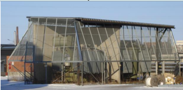
Muuntajasuoja (lähde Wärtsilä Finland, 2008)
