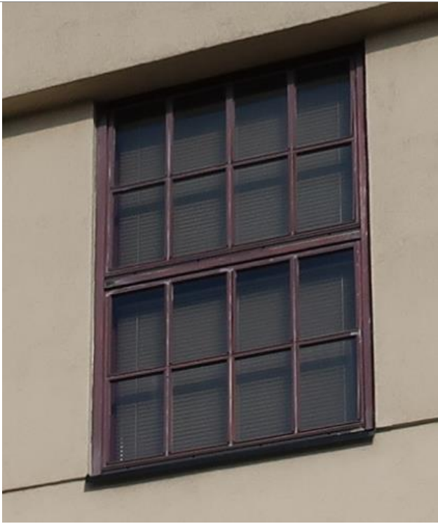
Vanhimpia 2. kerroksen ikkunoita eteläpäädyssä.
