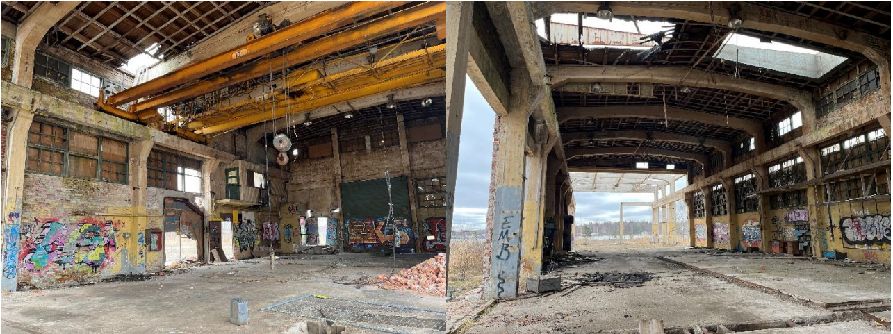
Kuva 4. Ostokohde vaatii laajoja saneeraus- ja kunnostustoimenpiteitä. 2023.
