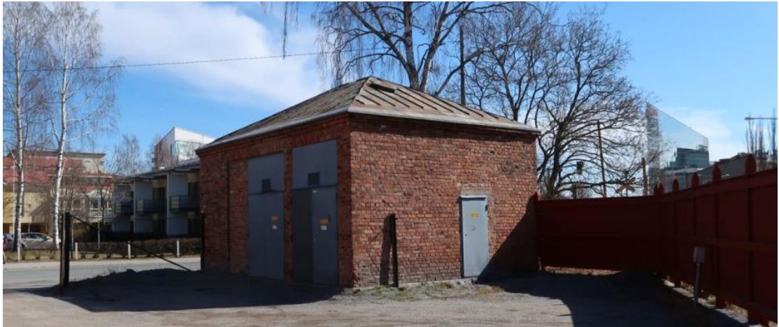
Muuntamo kuvattuna Wärtsilän tontin suunnasta. Kuva: Ramboll.
