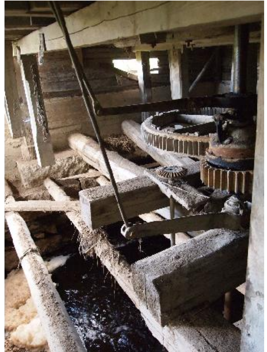
Alkuperäisenä säilynyttä turbiinikoneistoa ei viime kevättulvan jälkeen ole puhdistettu ja kunnostettu.
