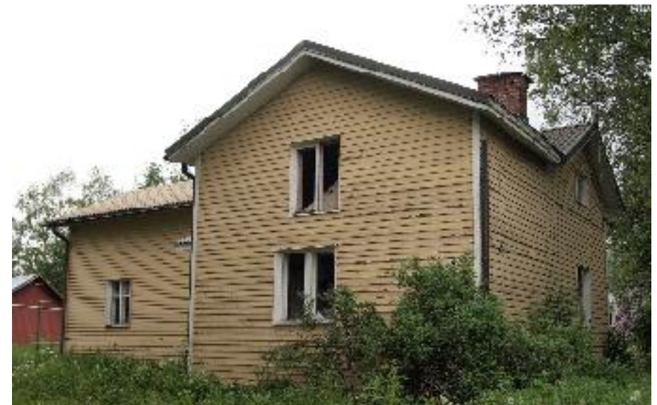
Avoimet ikkuna-aukot rappeuttavat nopeasti vanhaa taloa. Koillisesta kuvattuna
