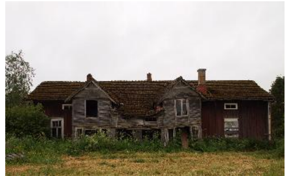
Asuinrakennuksessa (A) on rappeutunut kaksoiskuisti pihan puolella.
