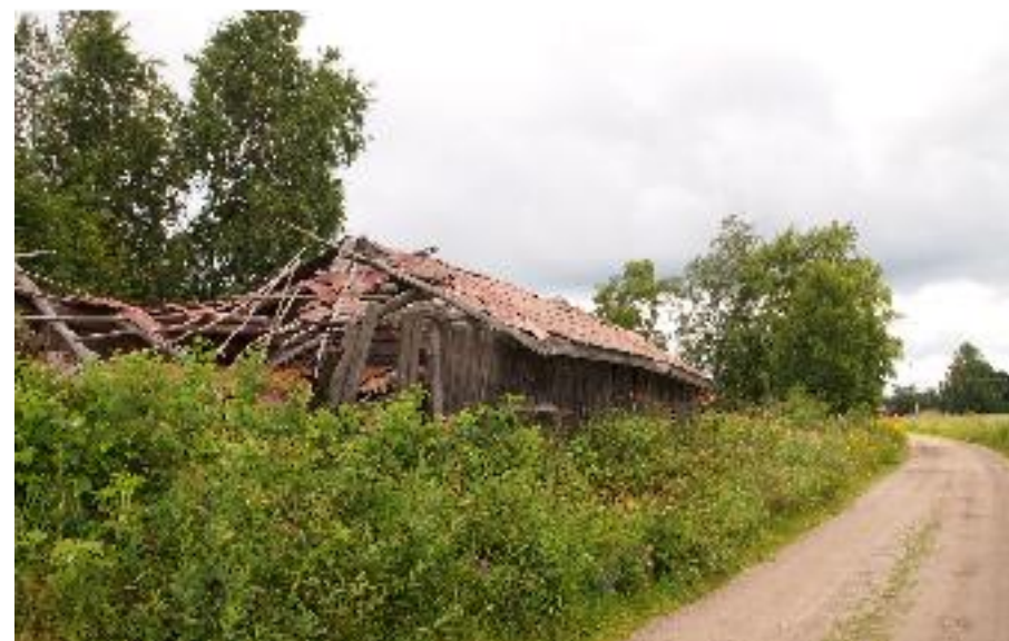
Romahtanutta ulkorakennusta (B) Haaronkujan varressa, koilliseen kuvattuna.
