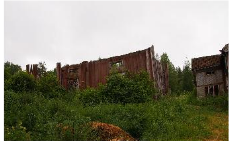
Vähätupa asuinrakennuksen pohjoispuolella on romahtanut.
