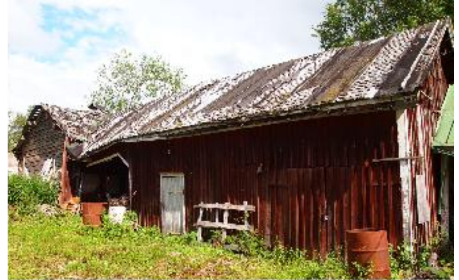
Kattoremontin tarpeessa oleva ulkorakennus (B) lounaasta kuvattuna.
