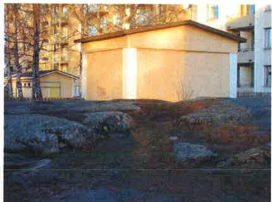
Muuntaja pihassa (Vaasan Sähkö)
