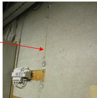
Kuva 32. IV-konehuone kellarissa. Lasivilla levytettyjä seiniä, IVkonehuoneessa
