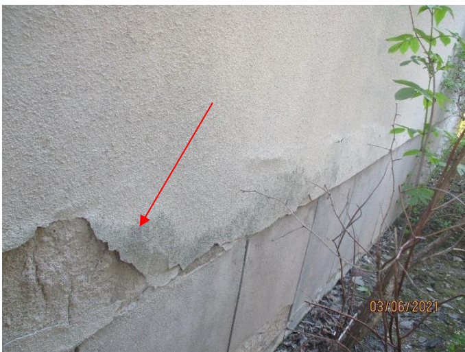
Kuva 55. Pääty, pohjoiseen Julkisivun rappipinta lohkoilee
